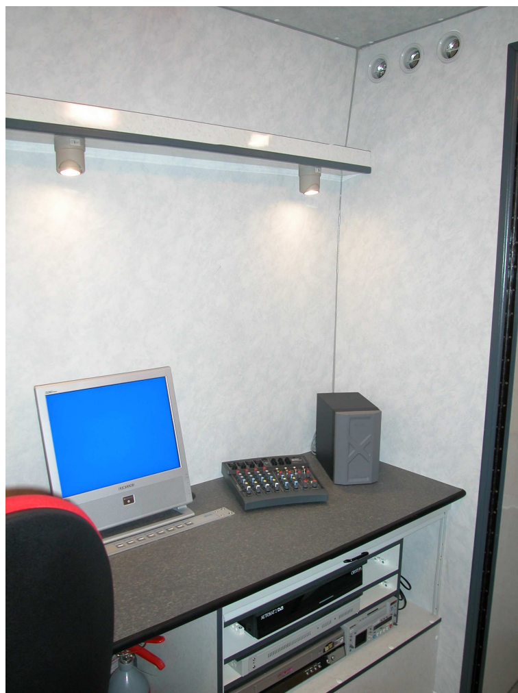
Foto n. 4 – La postazione per il controllo audiovisivo
